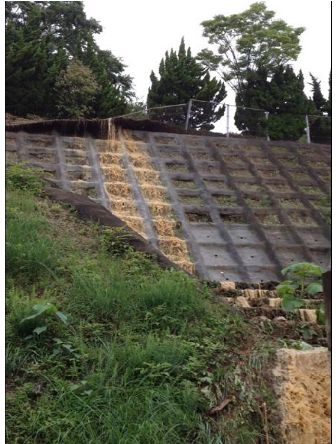
安浦町安登のこの団地では、高台の公園に土石流が流れ込み、フェンスを押し倒して、更にその下の住宅前まで流れて来ました。 写真は、流れが落ち着いた頃の様子です。
