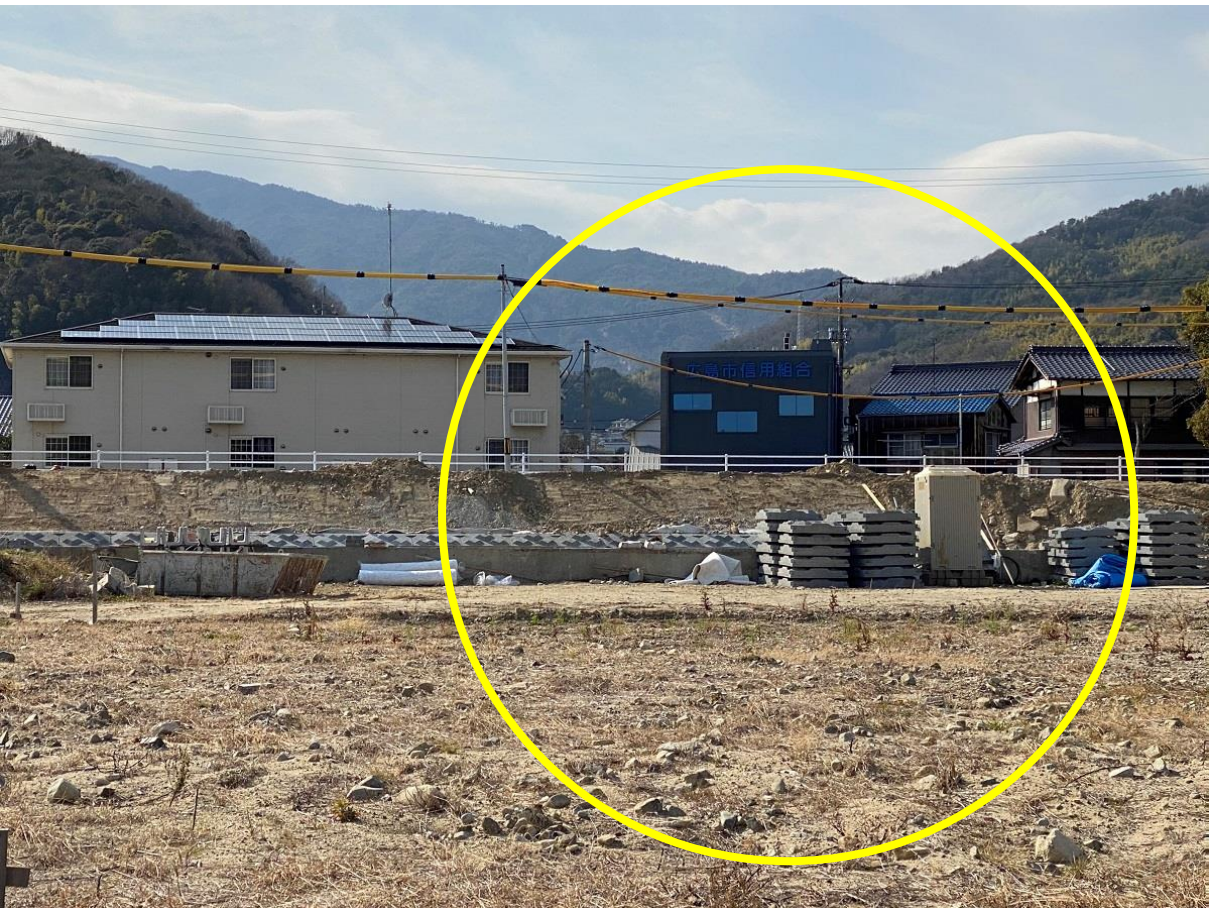
中畑川決壊箇所(復旧中)
